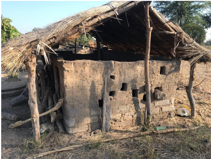
Figure 13 : Enclos à cochons en béton et terre cuite attaqué par des hyènes au niveau de la porte. L'enclos est certes en briques mais il n'est pas complet ni entretenu pour autant.
