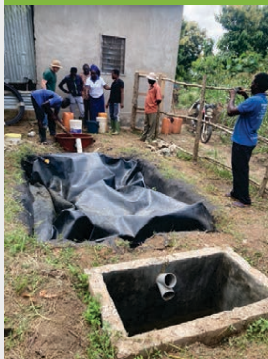
Installation complète Biodigesteur Sistemabio
